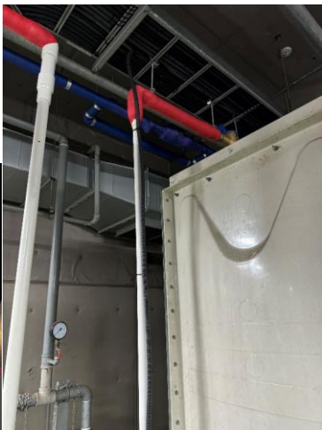
[드레인 배관, 물탱크 연결 모습]
